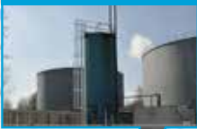
BIOGASSTATION RWZI LEEUWARDEN
